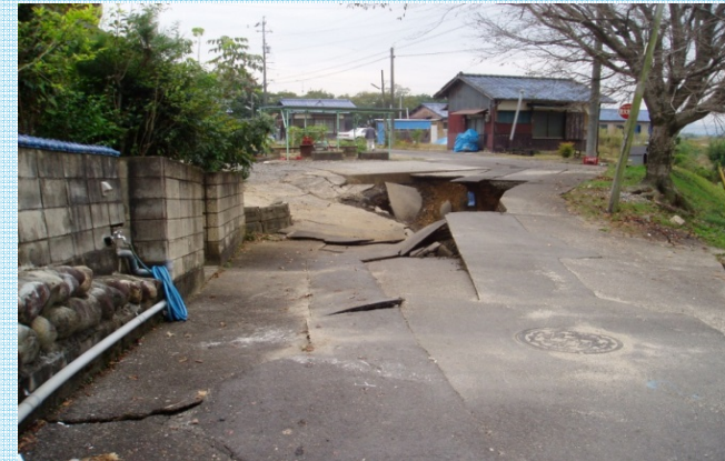
大規模陥没事故（岐阜県御嵩町）
