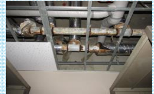
天井裏配管の老朽化による漏水
