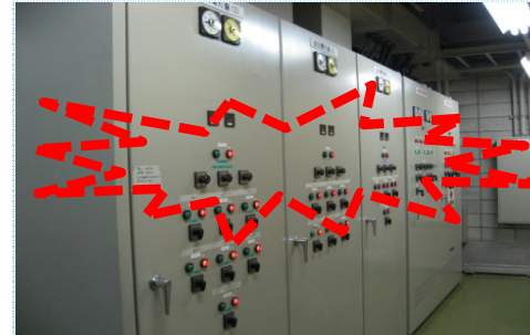
変電設備の動作不良による停電、磁気ひずみによる異音
