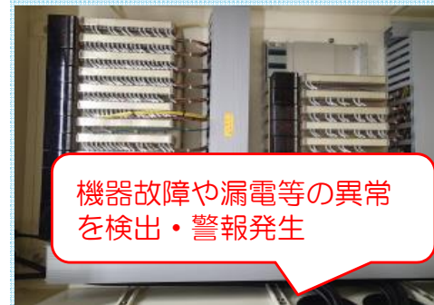
老朽化した電力中央監視設備
